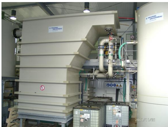
Sedimenter und Chemikalienvorratsbehälter
