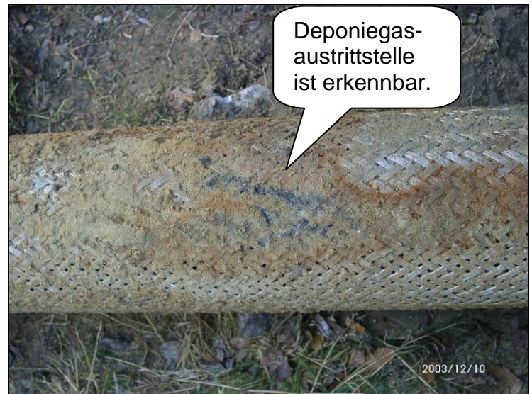
Bild 2: Schadhafte Stelle am Edelstahlkompensator.
