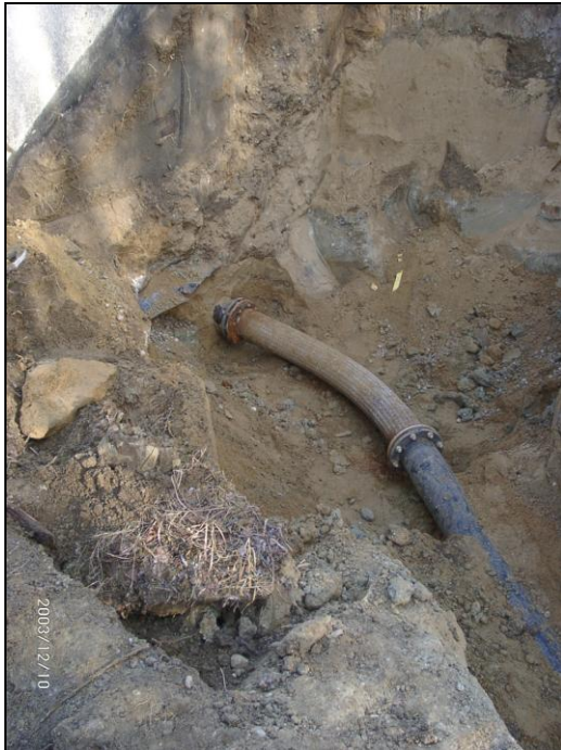
Bild 1: Einbausituation des schadhaften Edelstahlkompensator im Bereich der Regelstation 4
